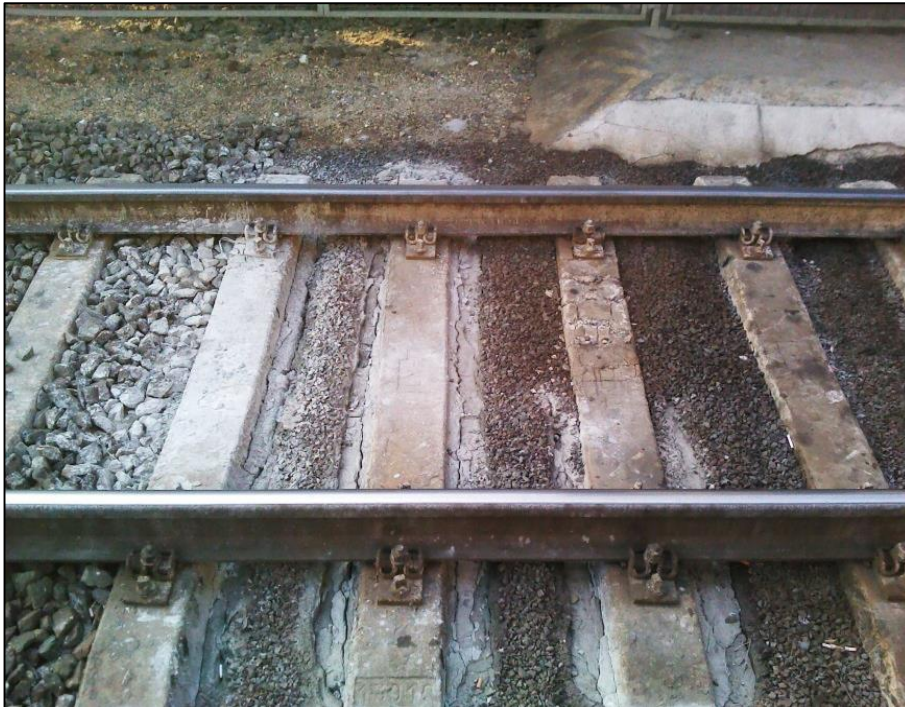
A III. vágány Postaalagút feletti szakaszának állapota
