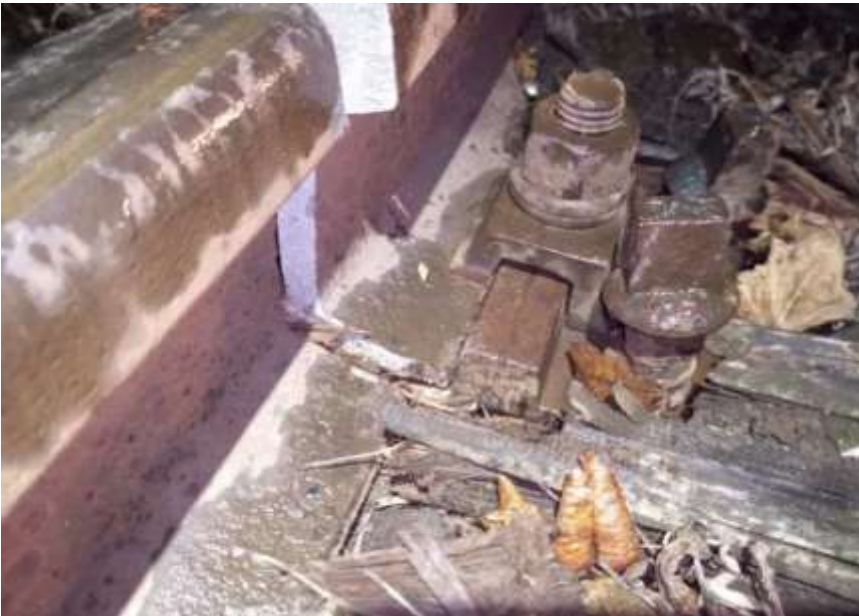
Benyomódott alátétlemez a kiszakadt csavarral [31]
